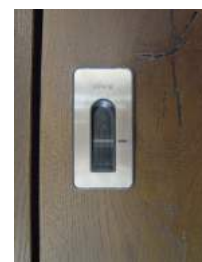
Im Türblatt eingelassener Fingerprint zur Ansteuerung eines elektr. Türschlosses Fabr. Genius von KFV (Zutrittskontrollsystem)
